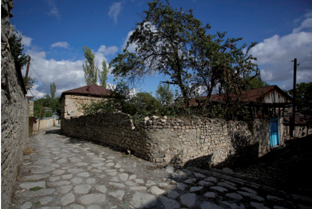
Daş hasarlı ev
